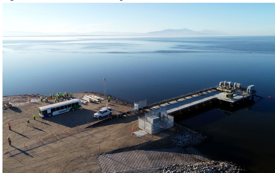
Figura 4. Estación de bombeo de agua salina en SCH.
